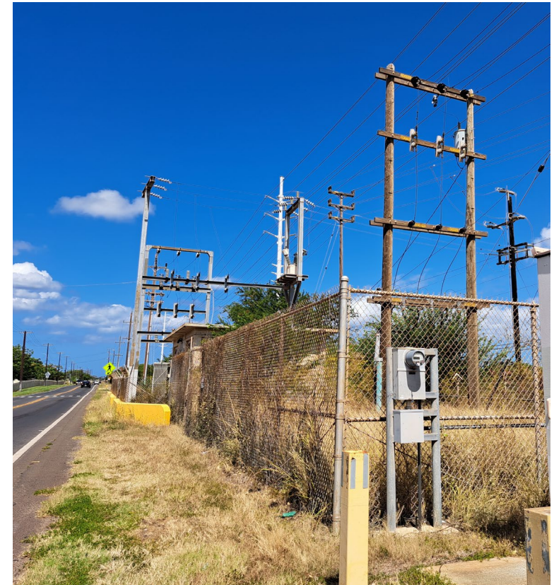
(Substation D, Roosevelt Ave., 6/27/2023)
